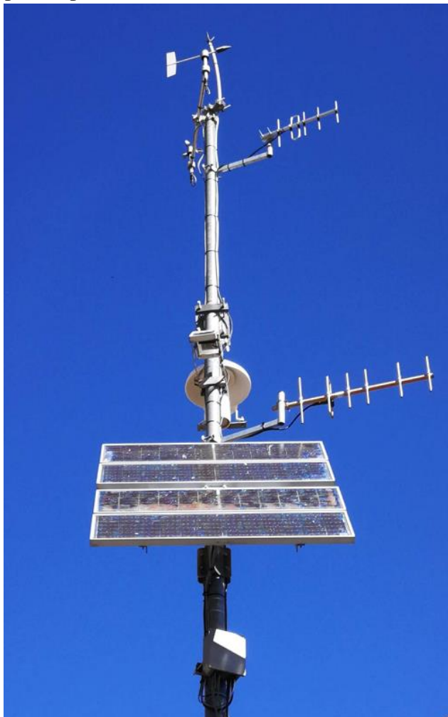
Il palo utilizzato e le antenne installate
