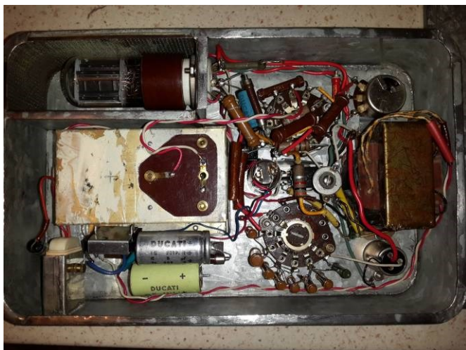
Un montaggio degno di ogni rispetto con vano per la valvola schermato e traforato per lo scambio d'aria
