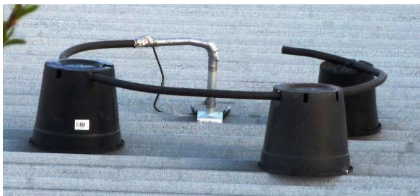
esempio di realizzazione provvisoria (27MHz)
